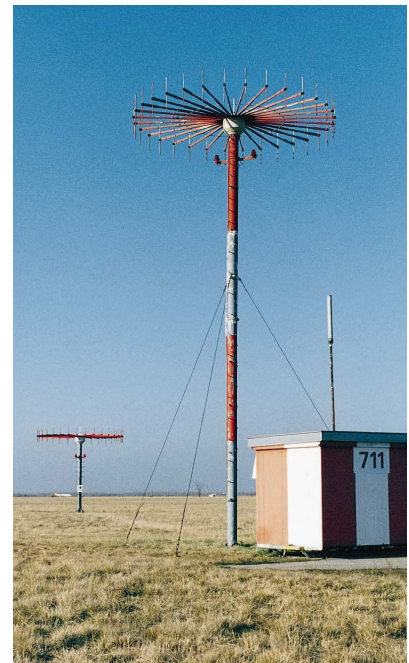
BILD 8 Zwei Peiler von Rohde & Schwarz in Wien Schwechat: der alte PA007, seit 21 Jahren zur vollen Zufriedenheit in Betrieb, und der neue PA100.
