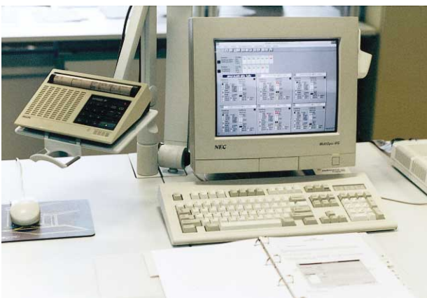
BILD 7 An Arbeitsplätzen wie diesem werden über eine Fernwirkanlage österreichweit alle Empfangsstationen überwacht und fernbedient.
