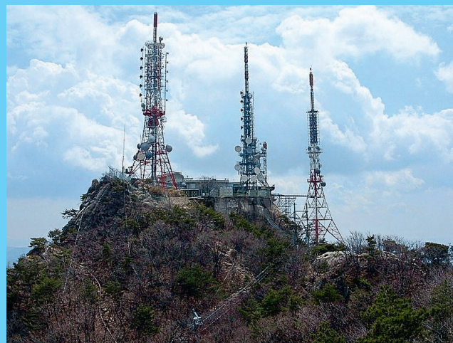
Por la torre de transmisión de KBS (izquierda en la imagen) se emiten los primeros programas en 4K del mundo.
